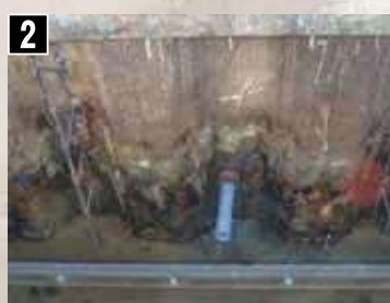
水抜きパイプ
