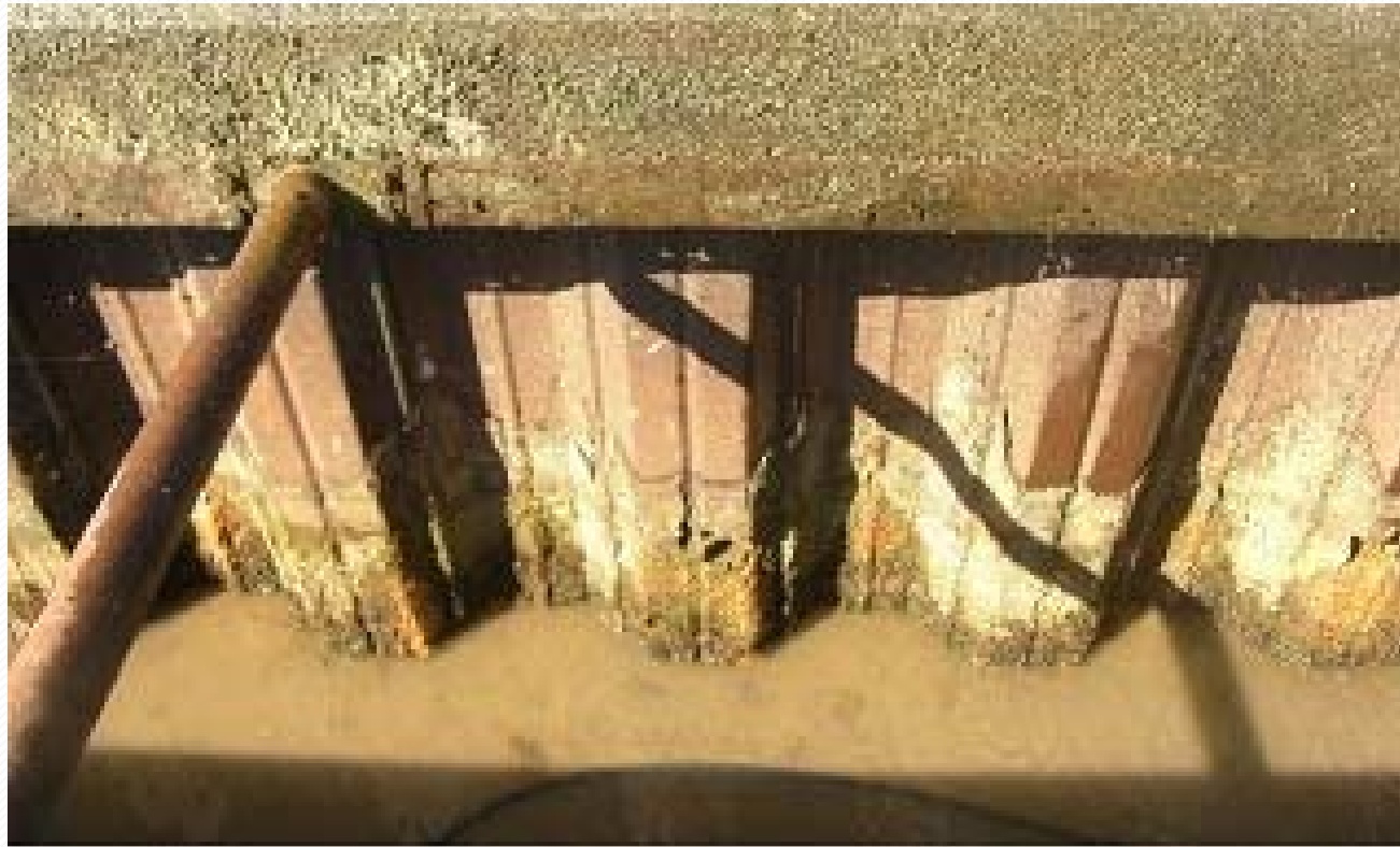
劣化の進んだ鋼矢板水路
